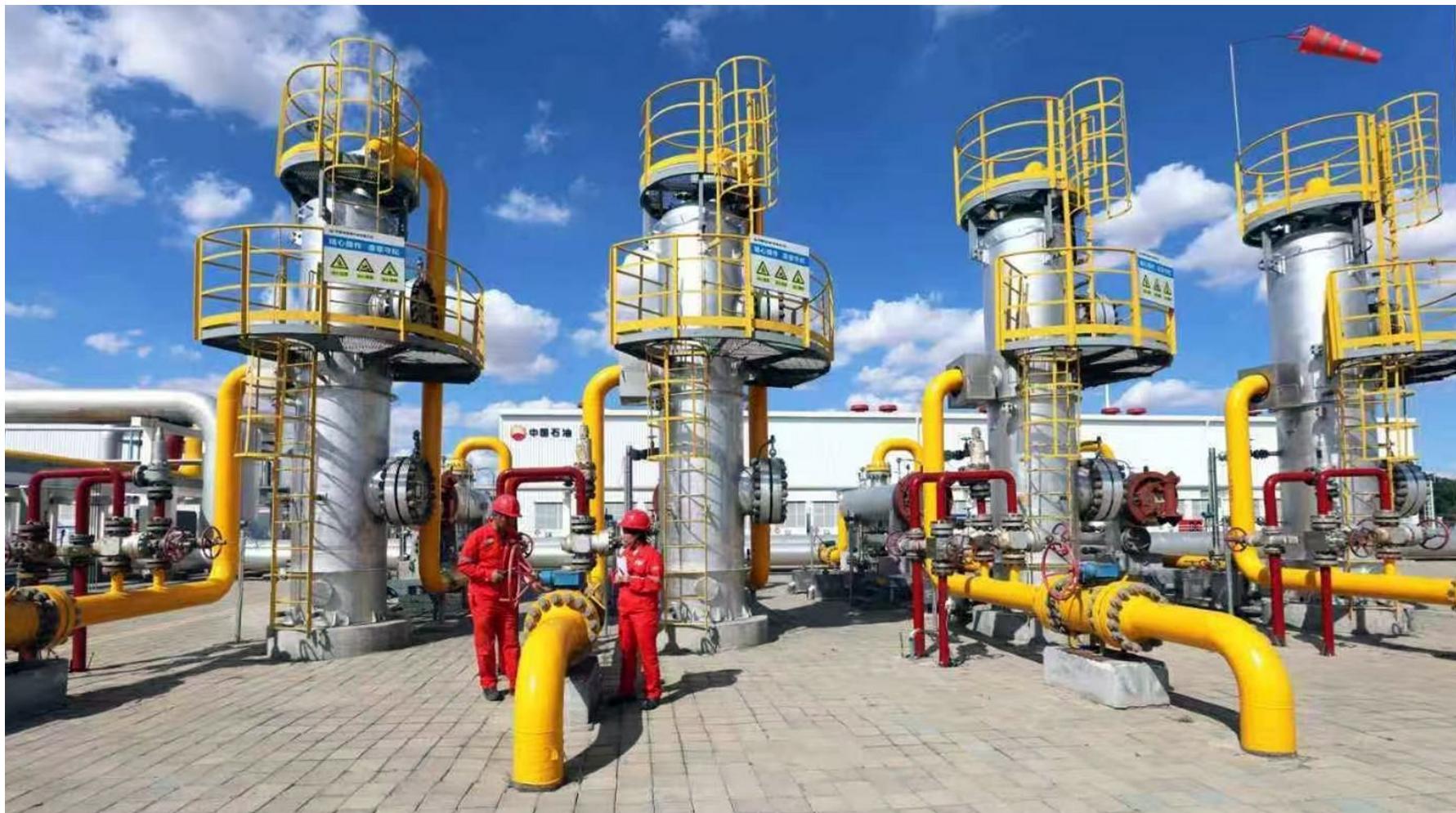
6月19日,在新疆油田公司呼图壁储气库生产现场,一线员工顶着烈日对设备进行逐一检查。
